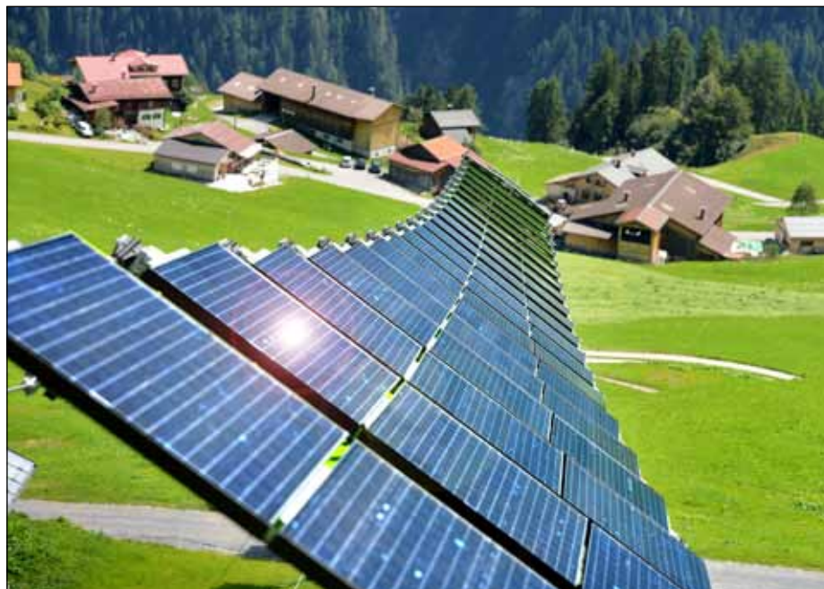
82 Solarwings mit je 3 Panels ermöglichen eine Produktionsmenge von 90.000 kWh pro Jahr
